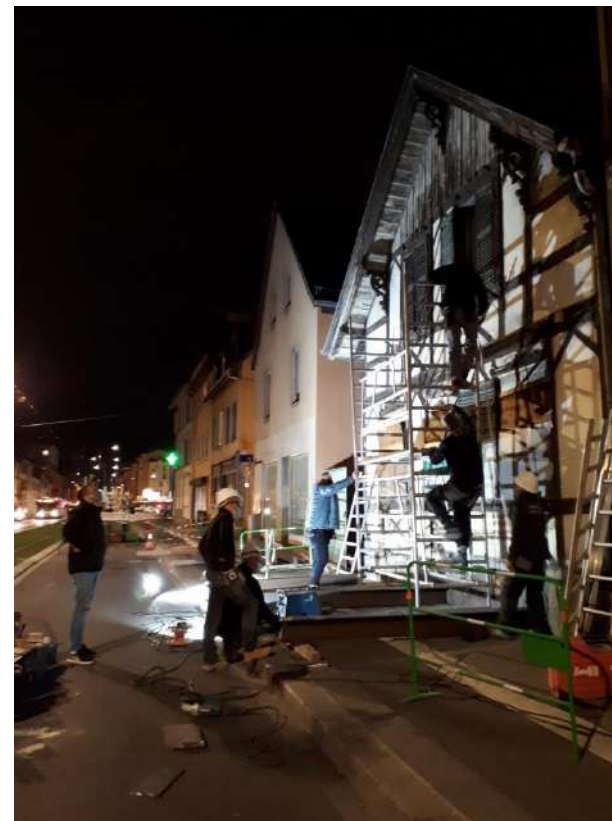
Sécurisation urgente, butonnage de la façade, arrêt du tram et de la circulation
