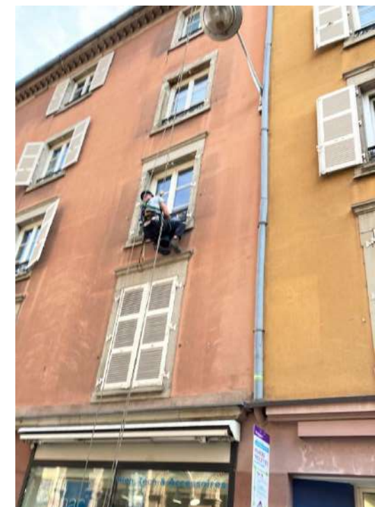
Purge urgente suite à chute d'encadrement de fenêtre, 1 blessé, dégâts matériels
