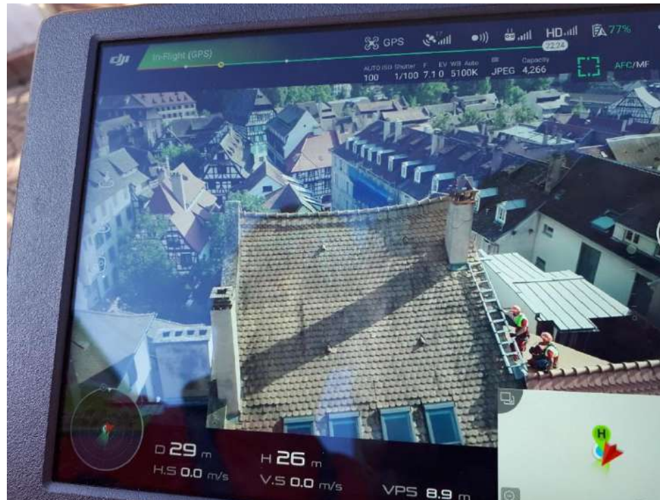
Suivi d'intervention concernant une cheminée qui menace de s'effondrer par drone
