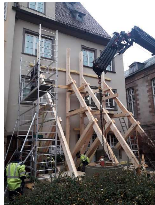
Butonnage d'une façade qui se désolidarise
